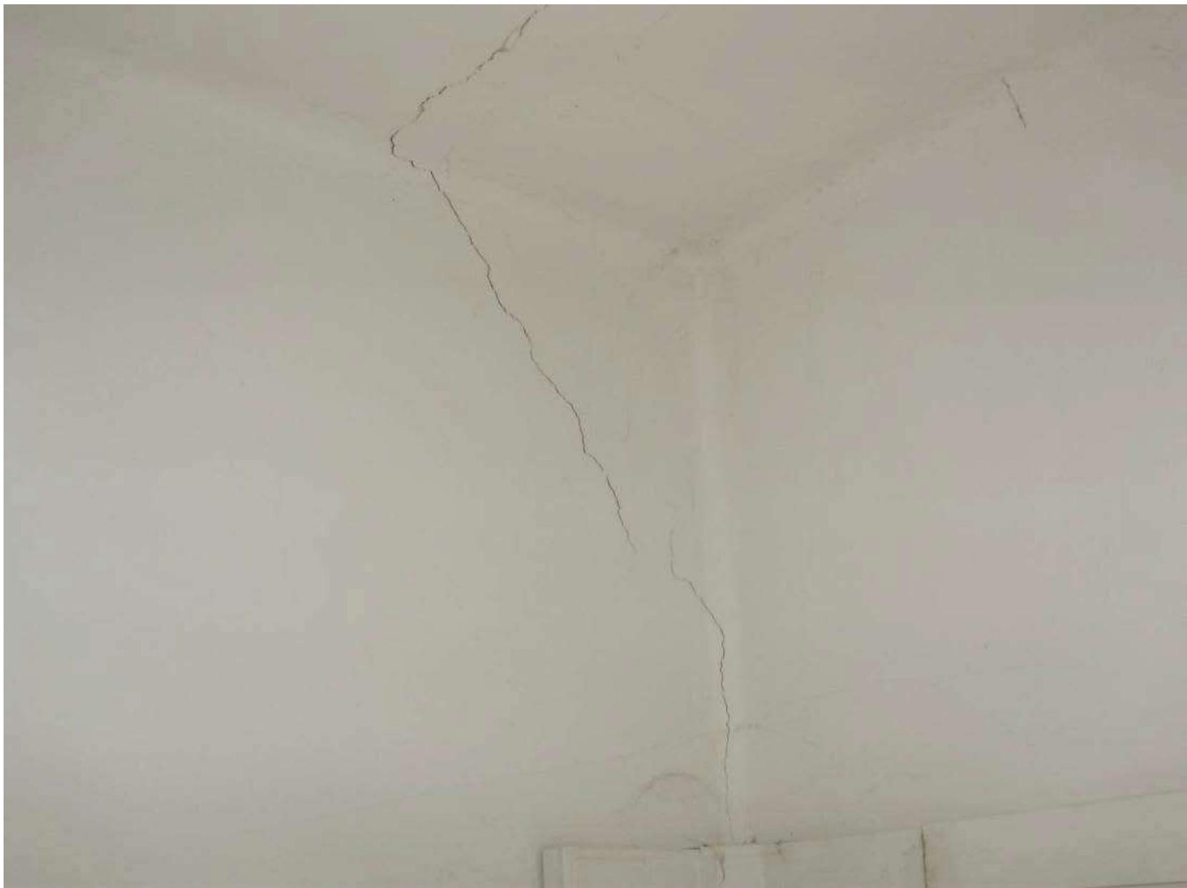
(3.1.1 F ) Solaio in putrelle e tavelloni su parete in muratura con inizio di distacco di intonaco e danno strutturale
