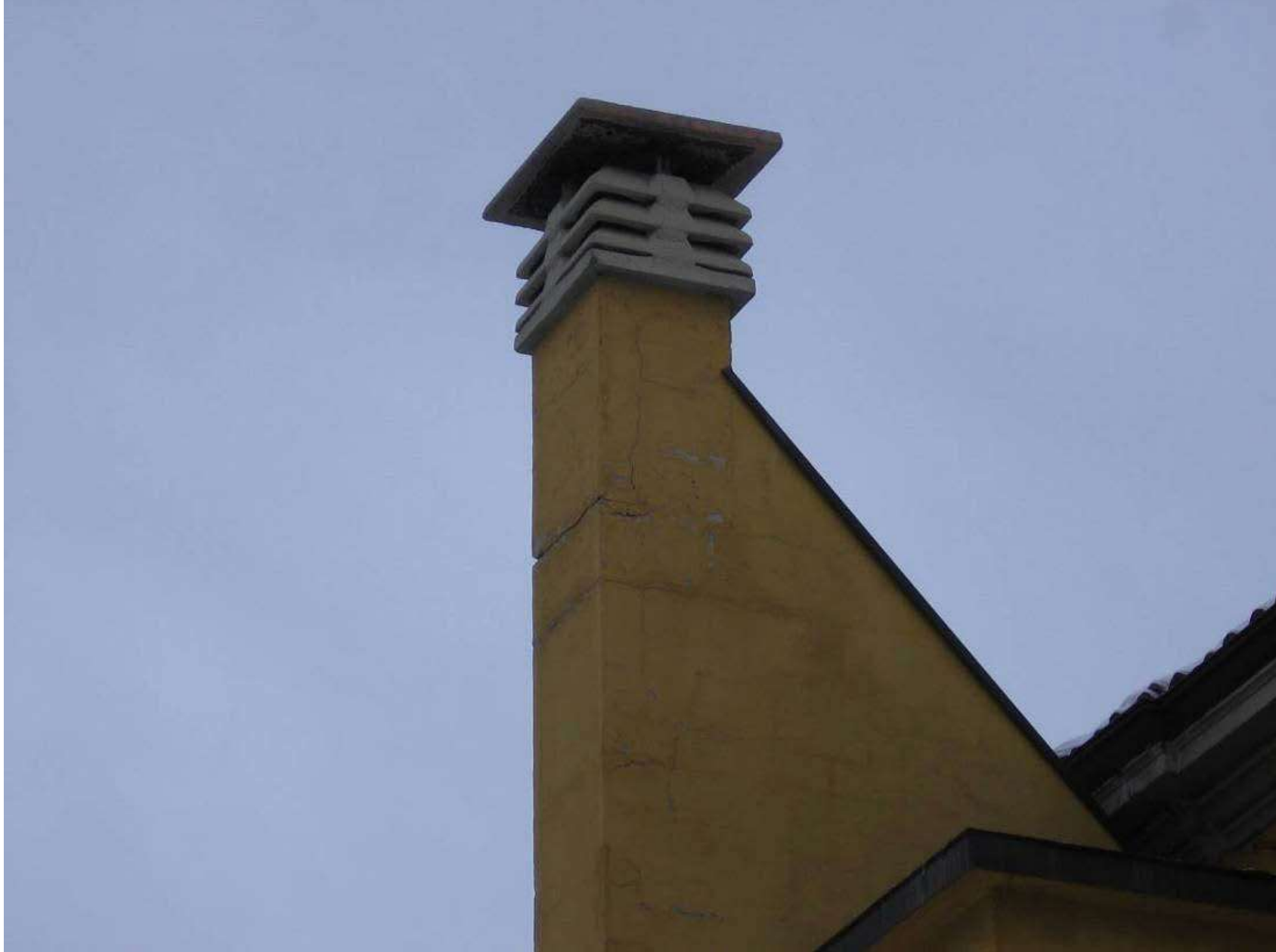
(3.2.3 F) Camino snello in una direzione, in muratura, e danneggiato
