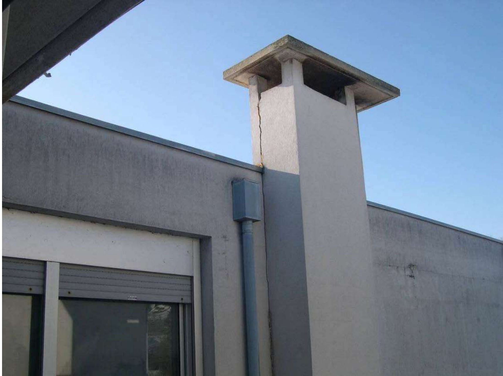
(3.2.3 F) Camino snello e danneggiato perché non bene ancorato; la piastra superiore è semplicemente appoggiata
